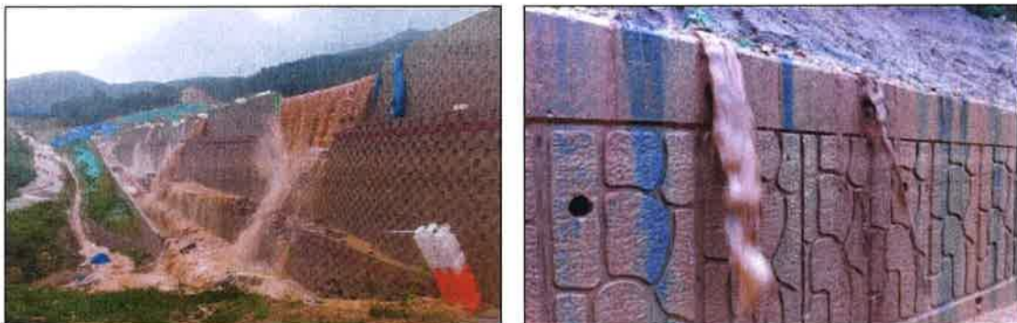
그림 15. 강우 시 낙수로 인한 옹벽 피해 현상
